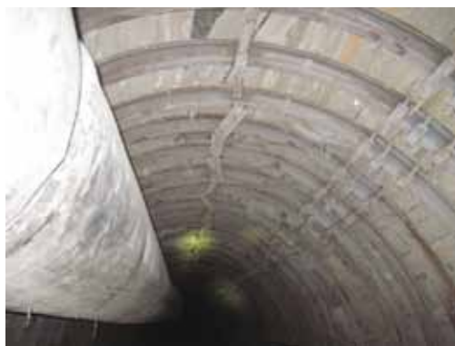
Рис. 6. Состояние вентиляционного штрека №3 в начале расчетной зоны ПГД
