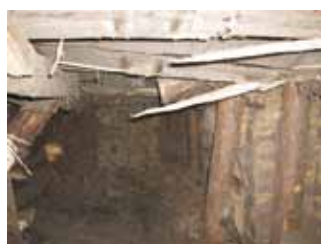
Рис. 7. Частичное разрушение полублоков в жесткой полосе
