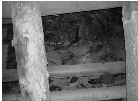
Рис. 2. Розкриття тріщин у нижній частині виробки
