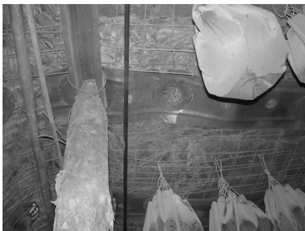
Рис. 3. Деформування елементів кріплення виробки
