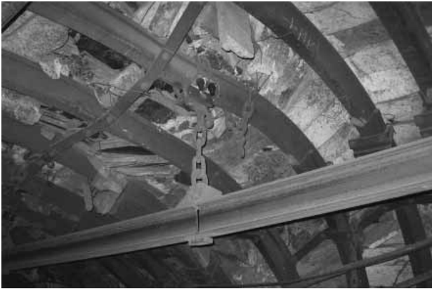
Рис. 1. Результат взаимодействия несущей рамы арочной крепи с массивом горных пород после многократного прохождения подвижного состава через стыковое соединение монорельса
