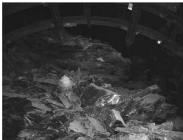
Рис. 5. Общий вид состояния кровли при буровзрывном способе разрушения пород в сечении проектного контура выработки
