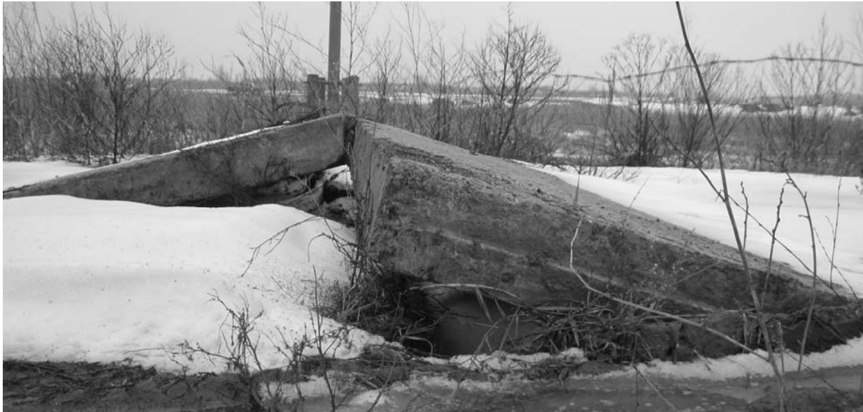
Рис. 2. Результат воздействия сжатий земной поверхности на бетонное покрытие дороги
